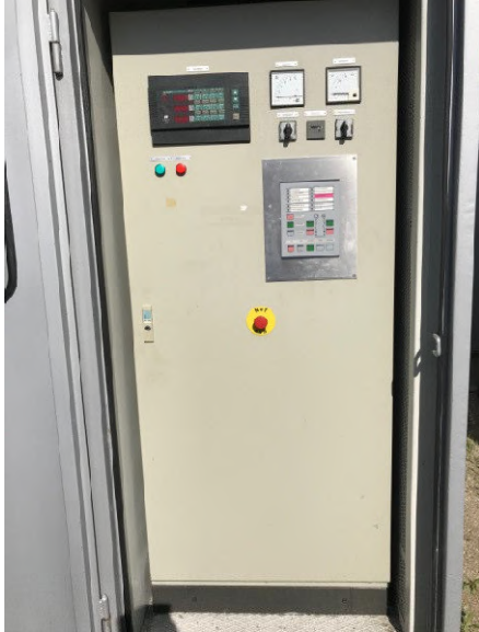
Schaltanlage (im Container-Heck):
