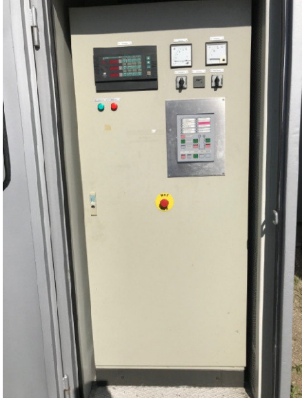
Schaltanlage (im Container-Heck):
